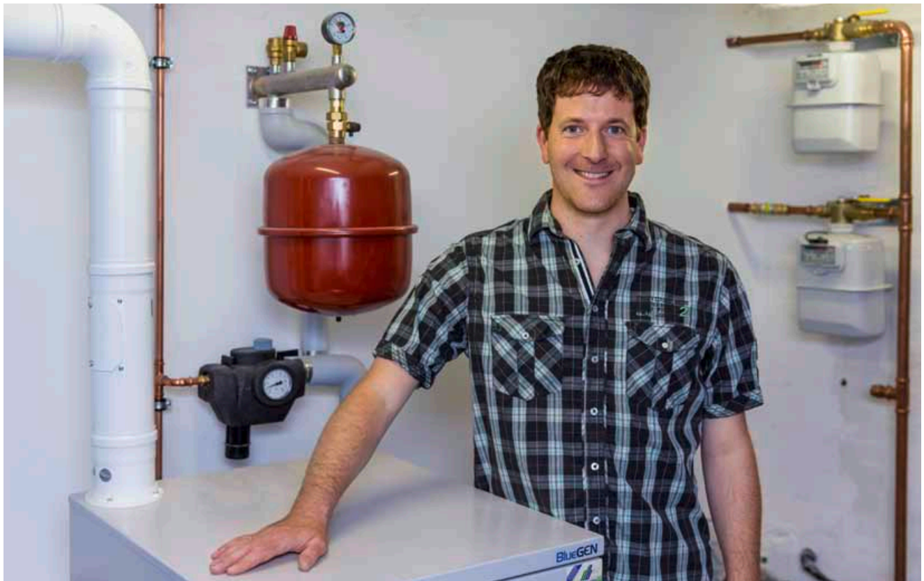
Zufrieden: Martin Pieren hat die Brennstoffzelle nach dem Pilotprojekt übernommen.
